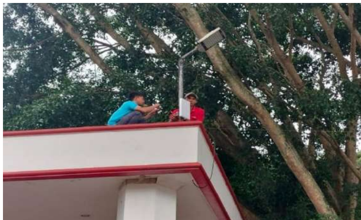
Gb 3.56 Kegiatan pemasangan Access point untuk wifi publik di area Alun-alun Temanggung
