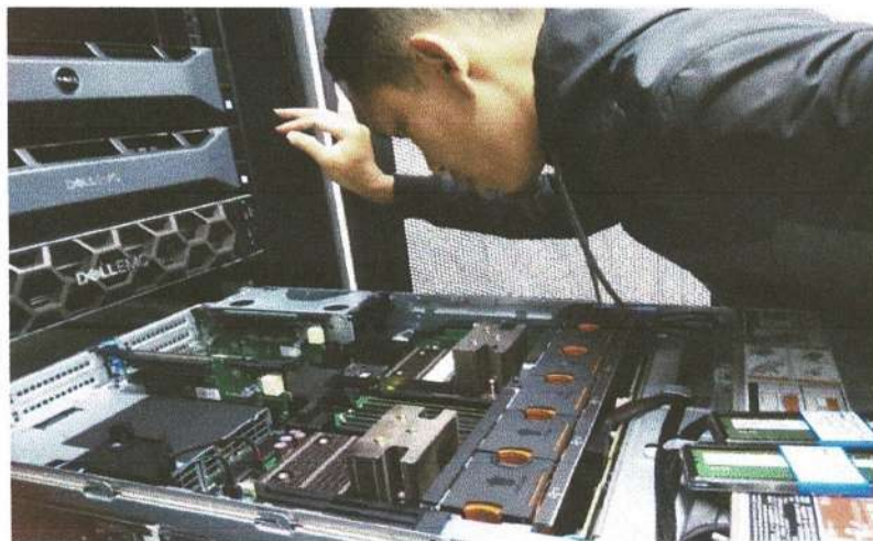
Gb. 3.20 Pemeliharaan Data Center
